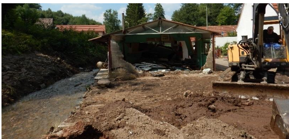
Abbildung 49 Eingestürzte Wand infolge Wasserdrucks (Beispielbild)
