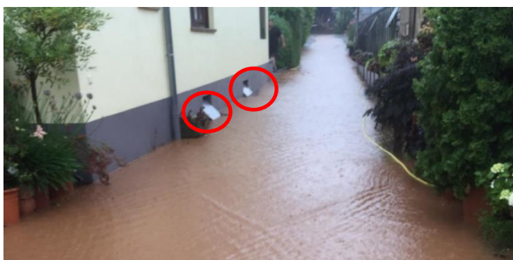
Abbildung 12 überflutungsgefährdete Fenster der Gärtnerei (11.06.2018. Quelle: Herr Weber)
