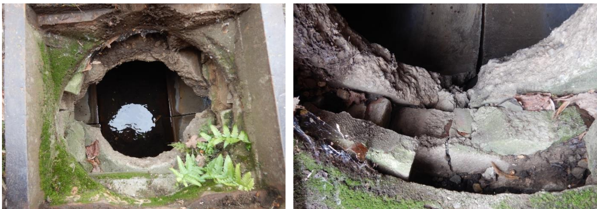
Abbildung 38 nicht fachgerecht eingebauter Ablauf in der Bachverrohrung in der Kirchgasse
